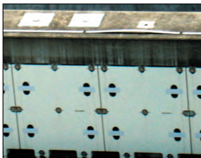
図3 軌道両側に設置の地上コイル
